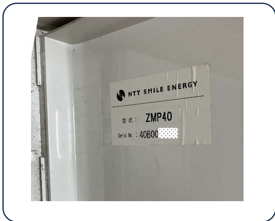
設備（モバイルパック）の裏蓋のシール（一例）
